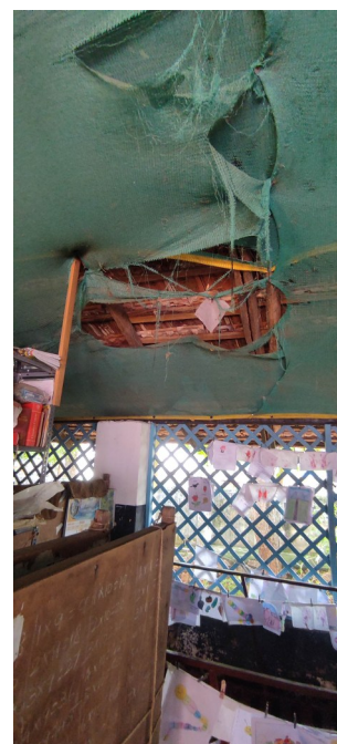
La toile de protection, usée et déchirée ne remplit plus son rôle en cas d'effondrement du toit
