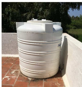
Potabilisée, elle se stocke dans un réservoir
